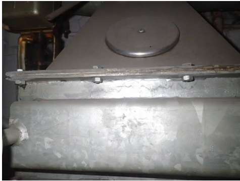
Guarnizione contenente amianto nell'impianto di aerazione. (Foto: C. Campoarmor, Arcadis Schweiz AG)
