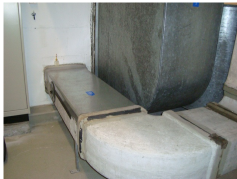
Canale di ventilazione in cemento amianto, Carbotech
