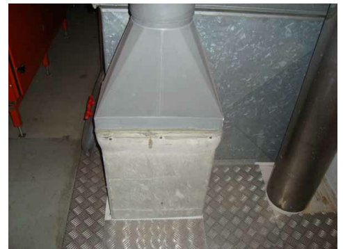
Canale di ventilazione in cemento amianto, con passaggio a condotto di plastica, Carbotech
