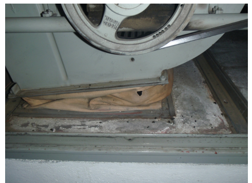
Tessuto contenente amianto tra il
