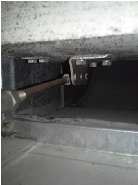
Serranda tagliafuoco con guarnizione contenente amianto.
