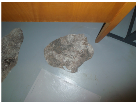
Rivestimento di pavimenti in resina sintetica contenente amianto nello strato di adesivo.
