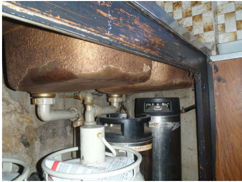
Revêtement d'insonorisation amianté sous évier
