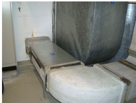
Conduit de ventilation en amianteciment, Carbotech
