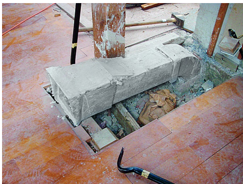
Conduit de ventilation en amianteciment
