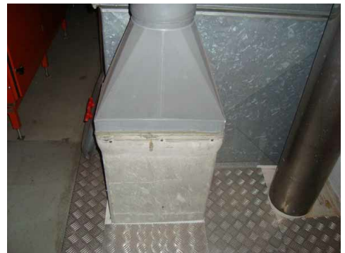
Conduit de ventilation en amianteciment, se raccordant au conduit en plastique, Carbotech
