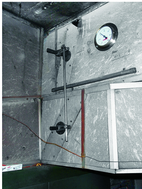
Conduit de ventilation en amianteciment
