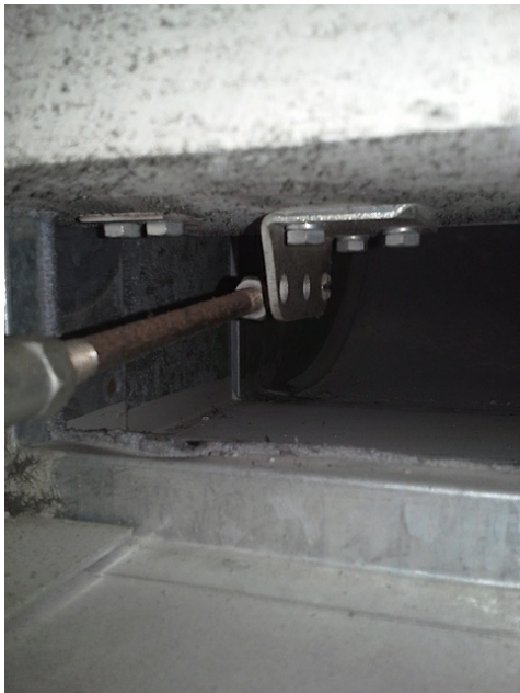
Clapet coupe-feu avec joint d'étanchéité amianté
