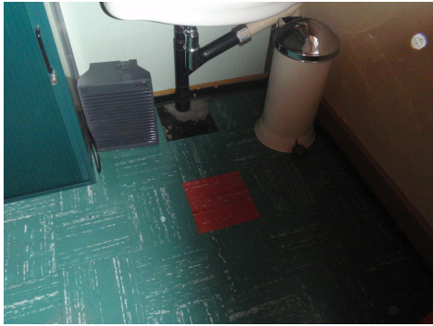
Daliette Vinyle contenant de l'amiante
