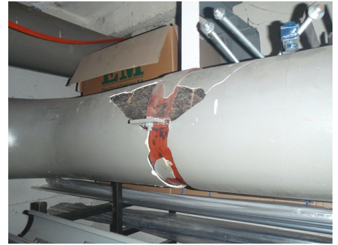
Rohrisolation Kork-Bitumen mit Gips-Verputz. Asbest im Gips
