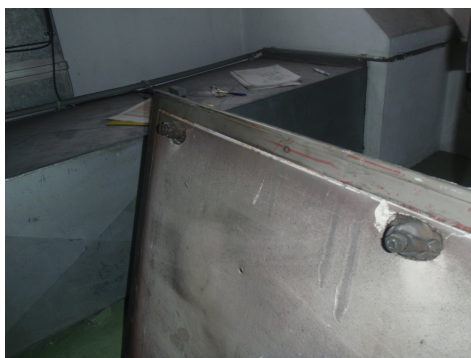
Inneres des Monoblocs Marke "Svenska" mit asbesthaltige Gips-Belag.
