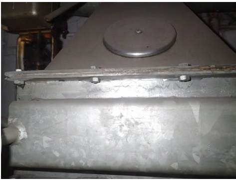
Asbesthaltige Dichtung in Lüftungsanlage. Photo: C. Campoarmor, Arcadis Schweiz AG
