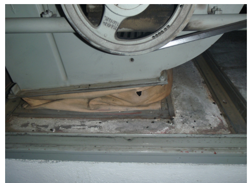
Asbesthaltiges Gewebe zwischen Lüftungsmotor und Sockel.
