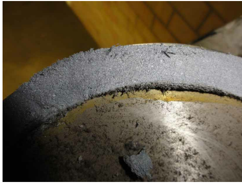
Detailaufnahme Litaflex an Heizrohr. Photo: Carbotech AG
