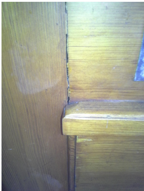
asbesthaltige Spachtelmasse auf Holz. Photo: Bafob GmbH
