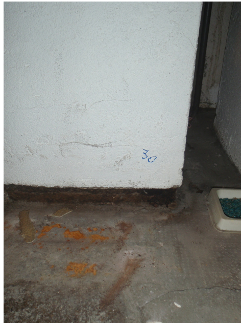
Asbestverdächtige Teerkork-Isolation unter Sockel von Liftmotor
