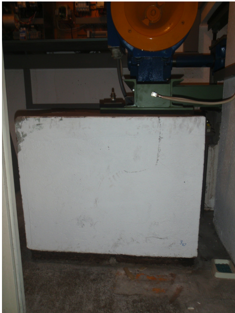
Asbestverdächtige Teerkork-Isolation unter Sockel von Liftmotor
