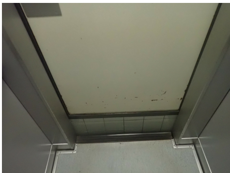
Lift mit Fliesenkleber als Stockwerkmarkierung
