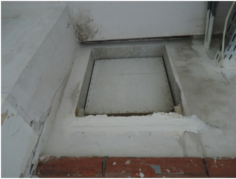
Leichtbauplatte auf Brandschutzklappe getackert, Arcadis Schweiz
