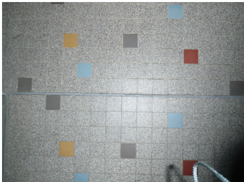
Fuge zwischen Fliesen - kann PCB enthalten.
