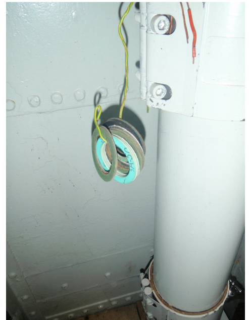
Vorrat an Dichtungen die Asbest enthalten können
