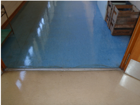
Bodenbelag vom Typ Linoleum
