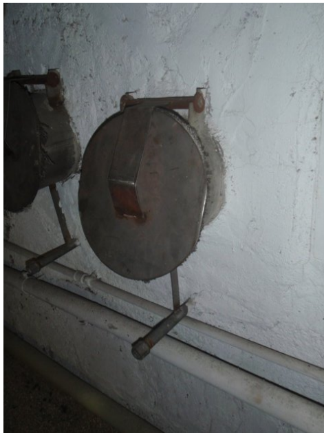
Klappen Kamin mit Asbest-Gewebe
