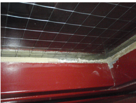
Brandschutztüre mit Asbestgewebe unter Fensterkitt
