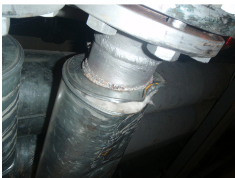
Asbestgewebe auf Rohr.
