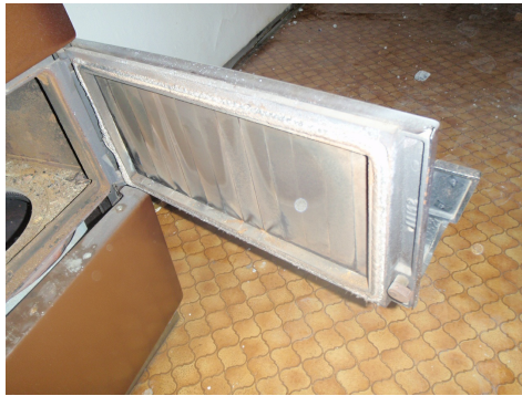
Asbest-Band in Ölofen
