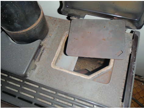
Asbest-Band in Ölofen
