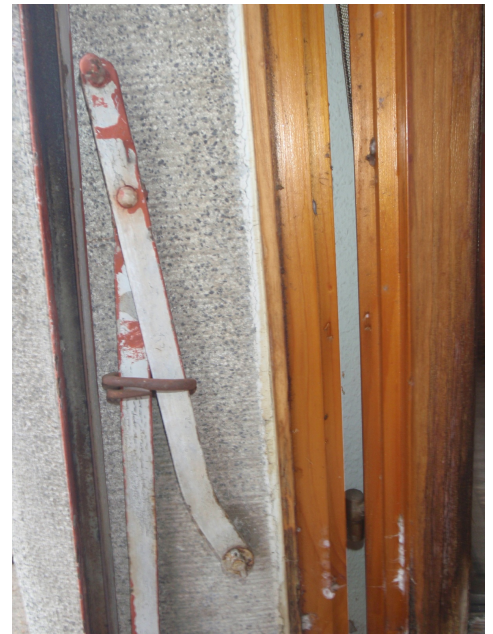
Anschlagkitt mit Asbest (zwischen Fensterrahmen und Mauerwerk)
